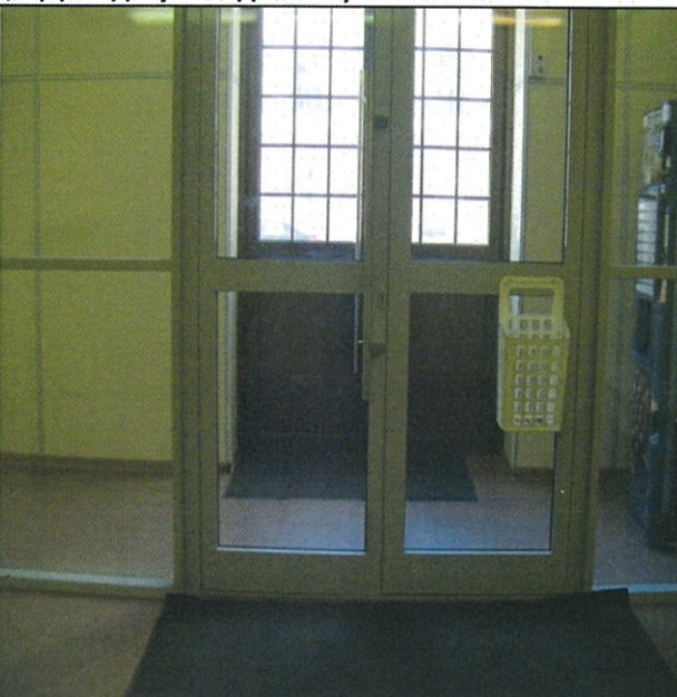
Фото 10. Входная дверь тамбурная
